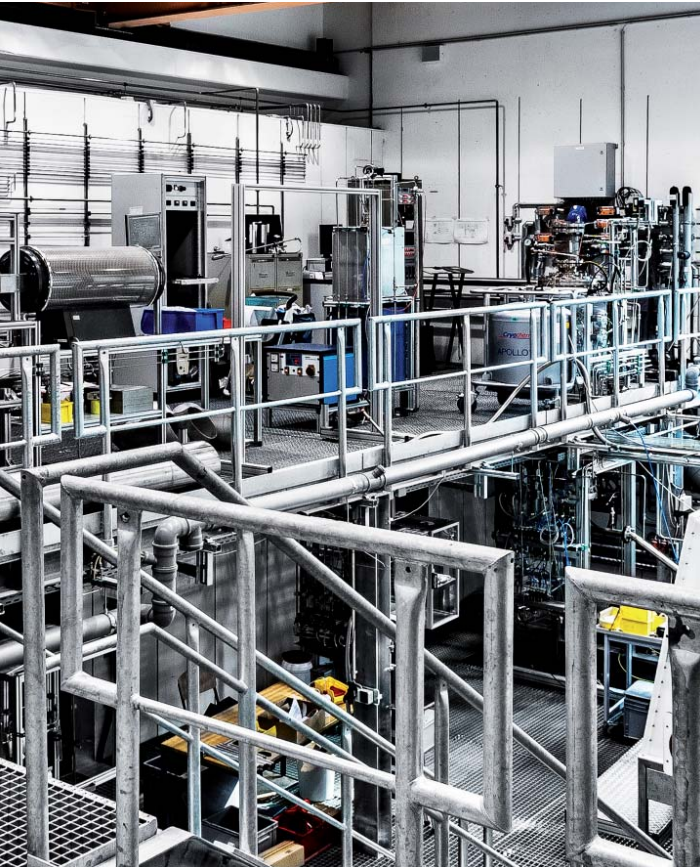
Auf drei Stockwerken steht die Anlage, die an der Universität Duisburg-Essen Nanopartikel herstellt.
